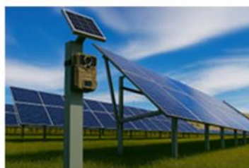
太陽光発電所の盗難対策
